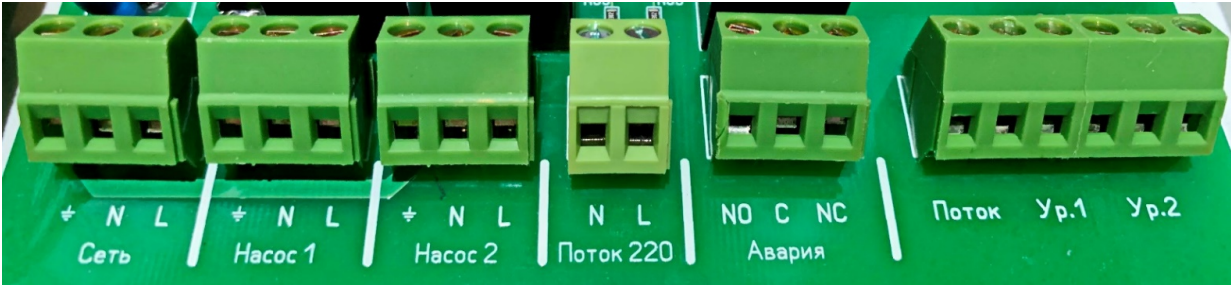
Клеммная колодка устройства (слева направо): Сеть · Насос 1 · Насос 2 · Поток 220 · Авария (NO C NC) · Поток · Ур. 1 · Ур. 2
